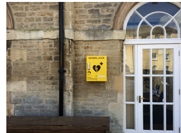
Automatischer Defibrillator in Bürogebäude (oben) und an Bushaltestelle (unten)
